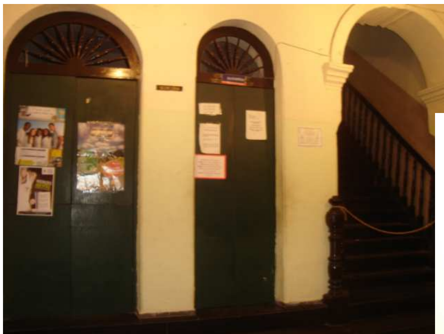
Foto 3: Entrada principal com escada interditada.
